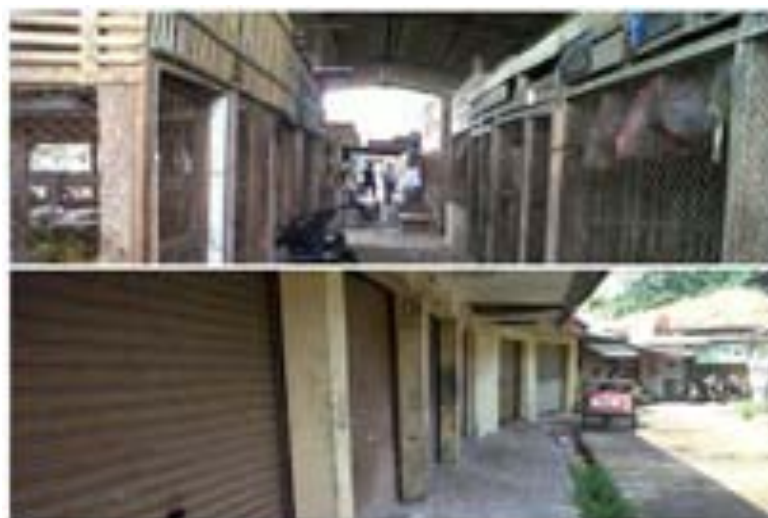
Gambar 1.3 Los dan Kios yang tidak dirawat
