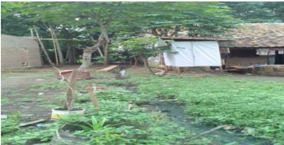
Gambar 4.4 Kondisi drainase di Kampung Tirtalaya RW 24 Kelurahan Serang Tahun 2016
