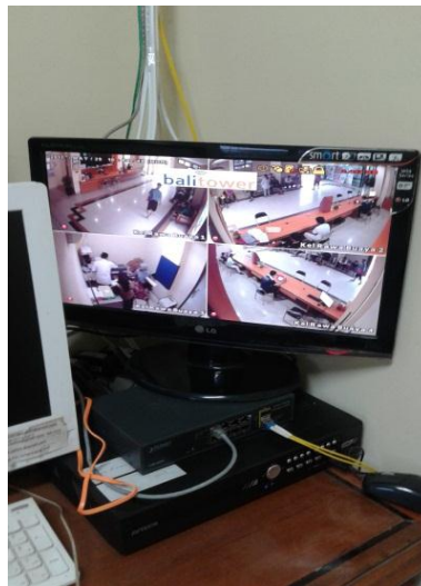
Cctv di Ruang Kepala KPTSP Jakarta Barat
