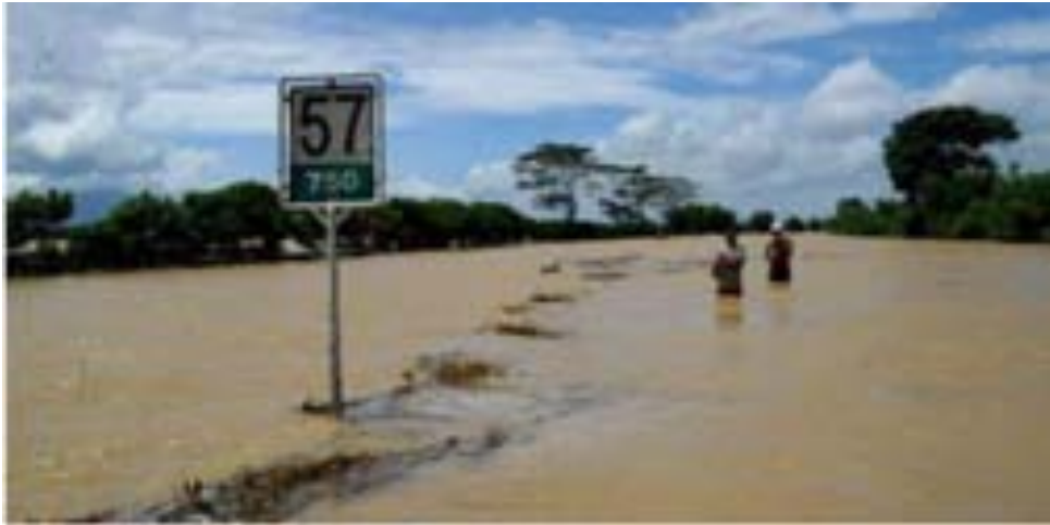
Kondisi Jalan TOLL Pada Banjir 2013
