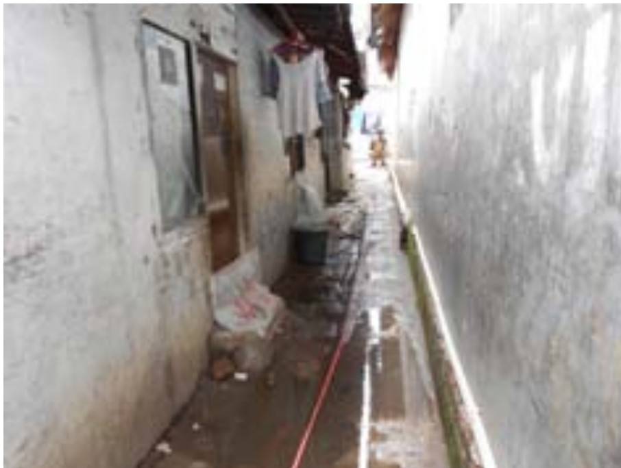
Kondisi Rumah Tidak Layak Huni di RT. 04/05 Kelurahan Jatake
