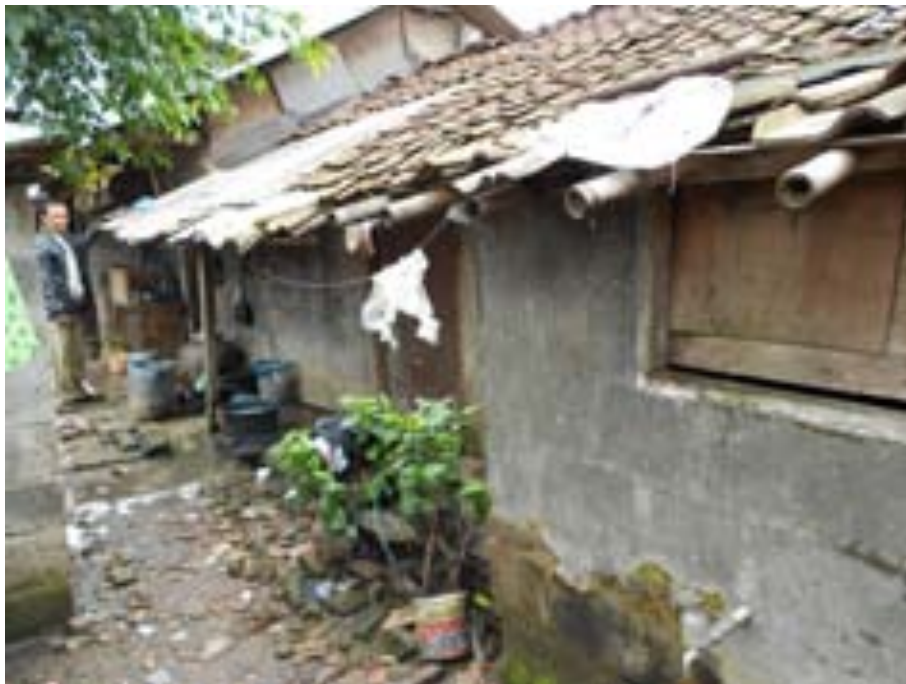
Kondisi Rumah Bangunan
