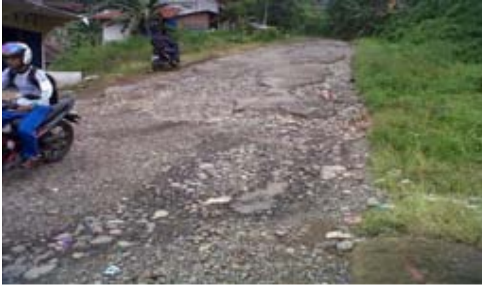
Kondisi Jalan Lebakgedong-Warung Banten, (05 Juni 2014)
