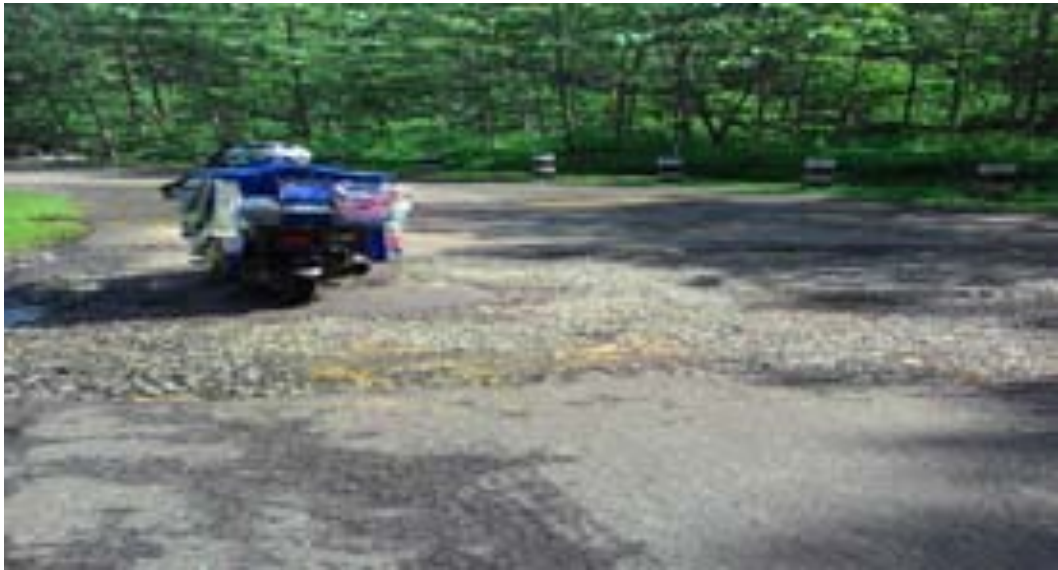
Kondisi Jalan di Kampung Ciladaeun, Desa Ciladaeun Kec. Lebakgedong (10 April 2014)
