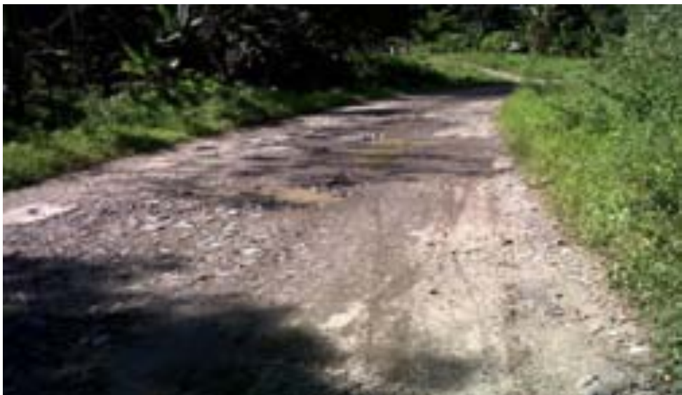
Kondisi Jalan Lebakgedong-Warung Banten (05 Juni 2014)
