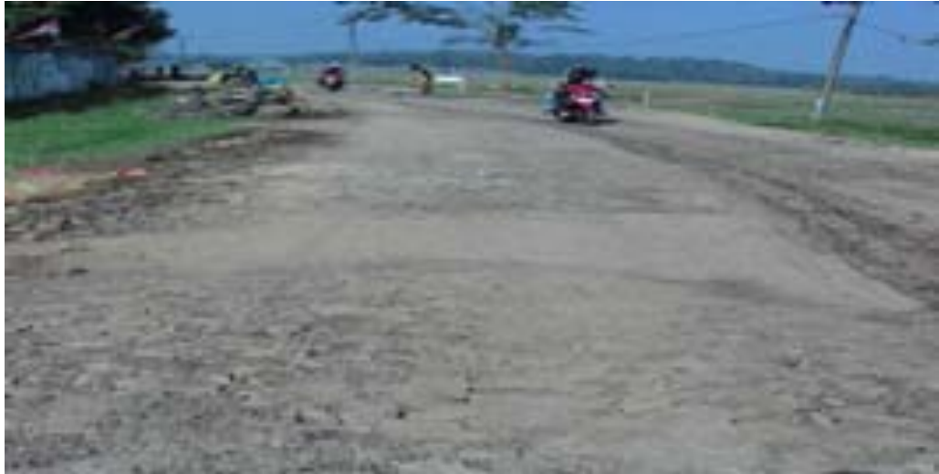
Kondisi Jalan di Kecamatan Cimarga (08 Agustus 2015)
