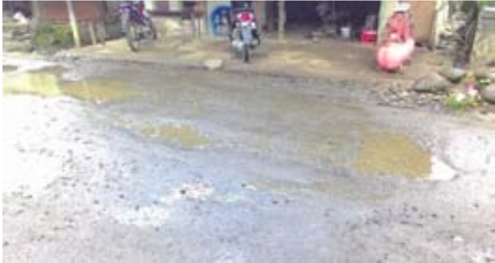
Kondisi Jalan di Kampung Cinyiru Desa Banjarsari Kec. Lebakgedong, (17 April 2014)
