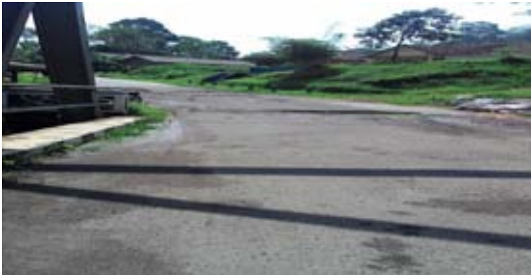
Kondisi Jalan Kampung Sangiang Kecamatan Lebakgedong (10 April 2014)
