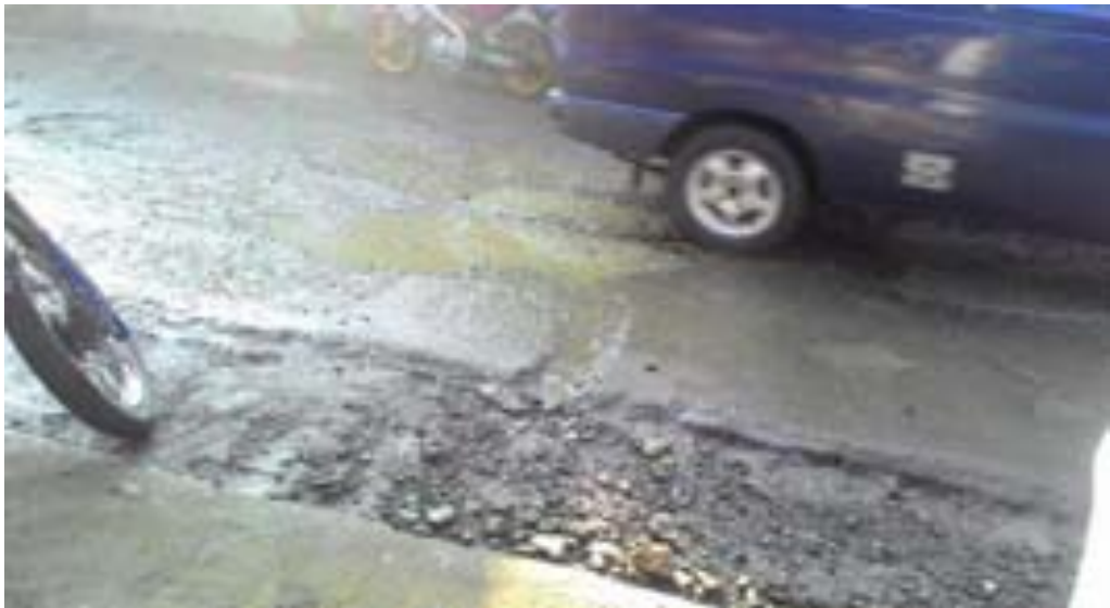
Kondisi Jalan di Kampung Muhara, Desa Ciladaeun, Lebakgedong (16 Mei 2014)
