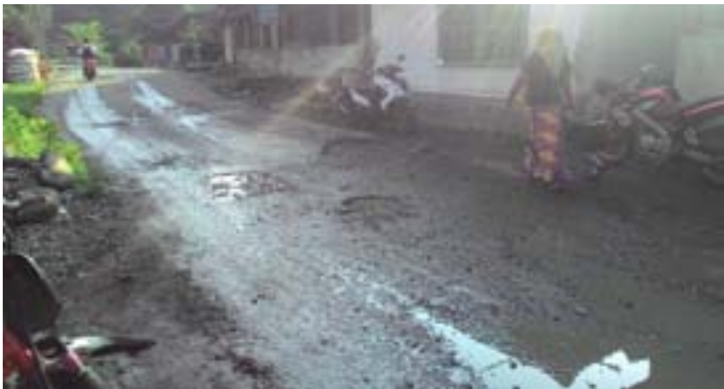
Kondisi Jalan di Kampung Muhara Kec. Lebak Gedong (16 Mei 2014)
