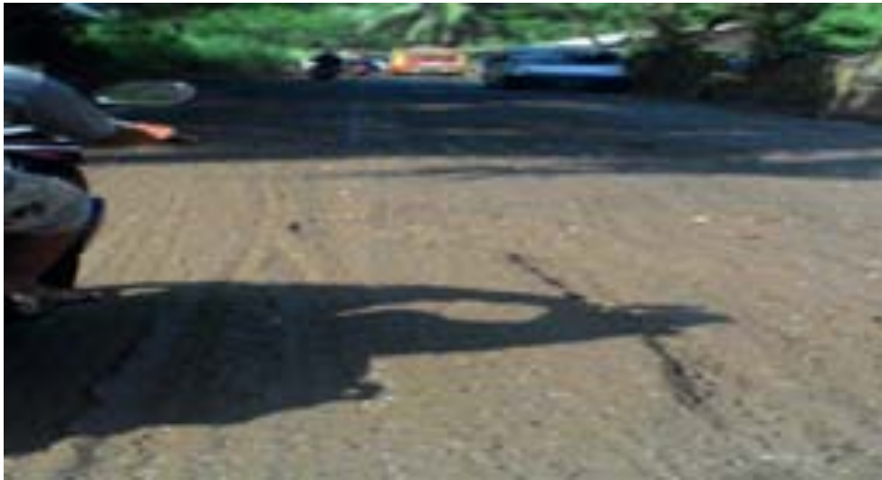
Kondisi Jalan di Desa Cimarga (08 Agustus 2015)
