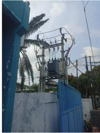
Gambar 2.4 Trafo Distribusi Penyulang Panimbang
