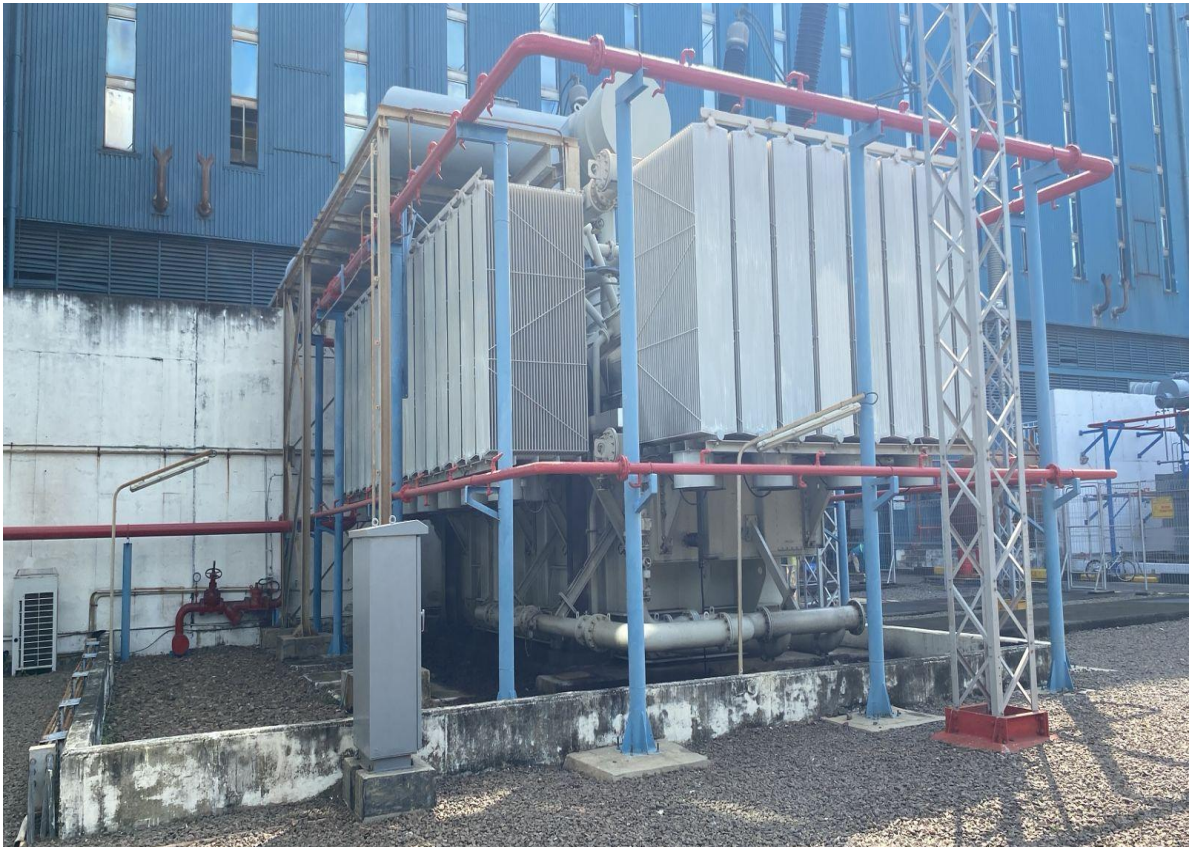
Gambar B. 1 Transformator Step-Up 500 MVAUnit 1 dan unit 2
