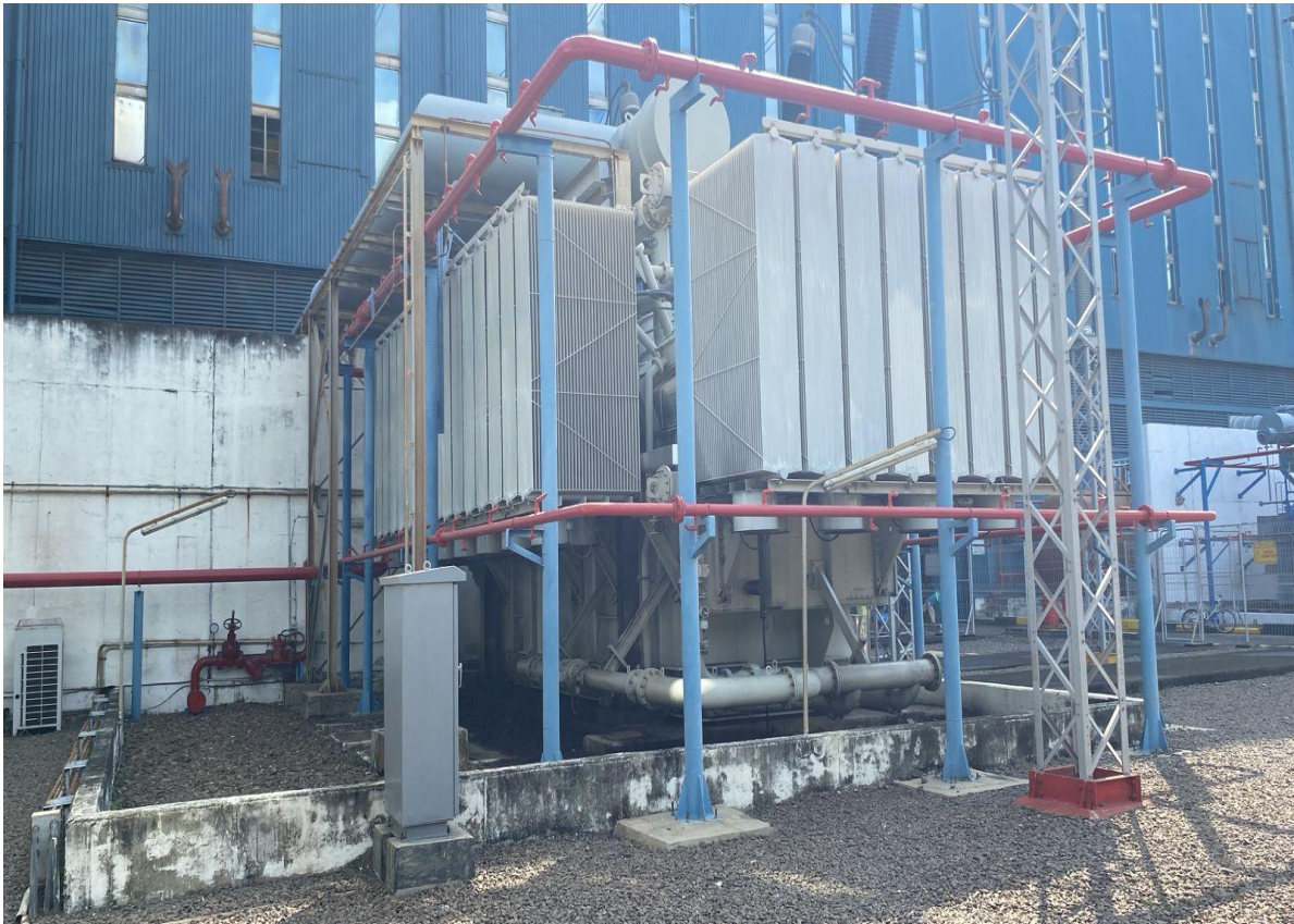
Gambar B. 1 Transformator Step-Up 500 MVAUnit 1 dan unit 2
