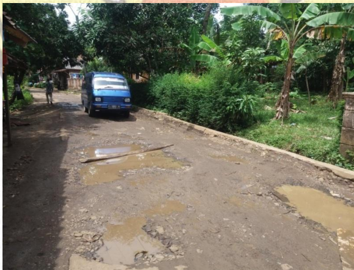
Gambar 2: Kondisi infrastruktur jalan menuju Destinasi Pariwisata Makam Keramat Syeh Mansyur Cikadueun Kecamatan Cipeucang yang sangat rusak dan mengganggu para pengunjung. (Dokumentasi Peneliti) gambar diambil pada tanggal 30 Oktober 2016.
