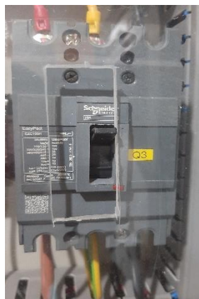
Gambar 4.3 Kapasitas Pengaman pada PP AC Lantai 6
