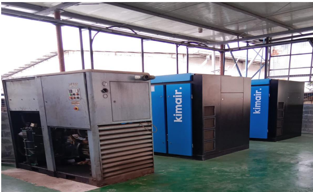
Kompresor utama pada PT. Geum Cheon Indo
