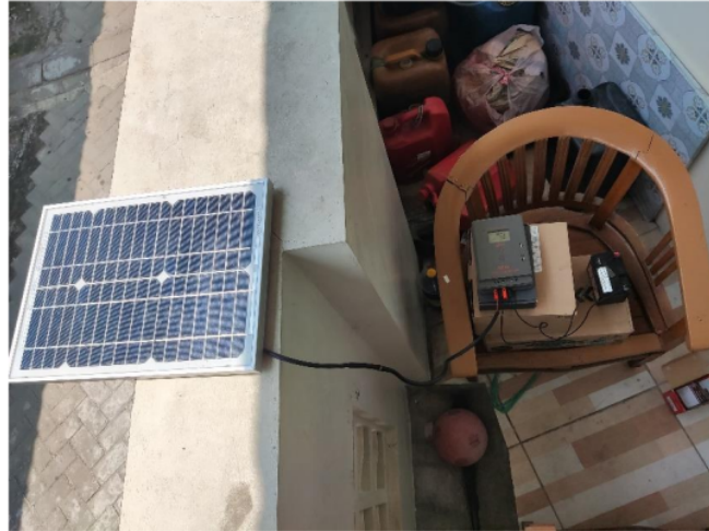
Gambar 4.13 Monitoring Pengisian Aki dengan Panel Surya
