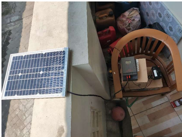
Gambar 4.13 Monitoring Pengisian Aki dengan Panel Surya
