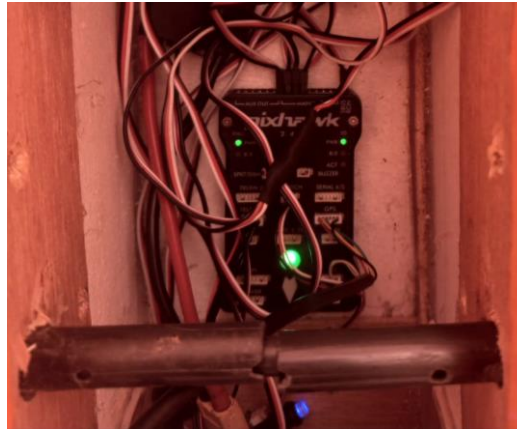
Gambar 4.3 Komponen Elektrik di Wahana.
