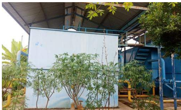
Gambar 3.2 Instalasi Pengolahan Air (IPA) Kopo
