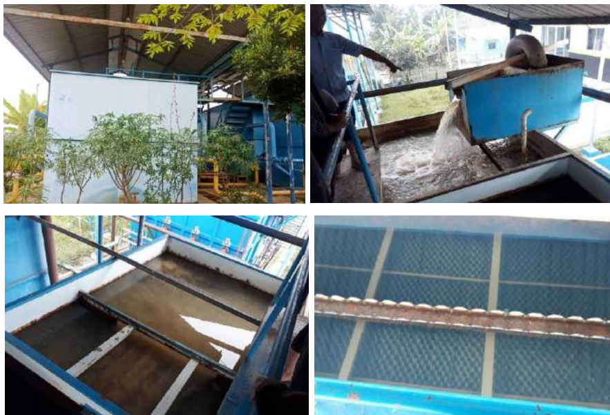
Gambar 2. Instalasi Pengolah Air (IPA)
