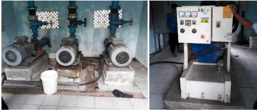
Gambar 4. Ruang Pompa dan Peralatan Elektrikal
