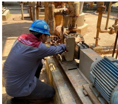
Gambar 4.8 Pengukuran Vibrasi pada Pompa Sentrifugal G-930 A
