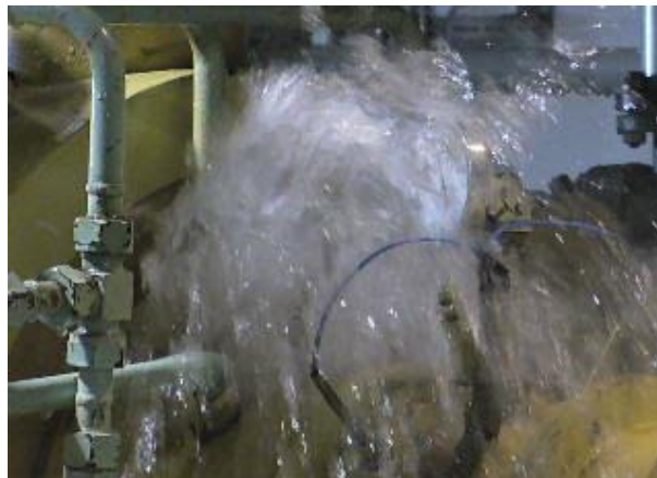
Gambar 4.6 Mechanical seal yang bocor
