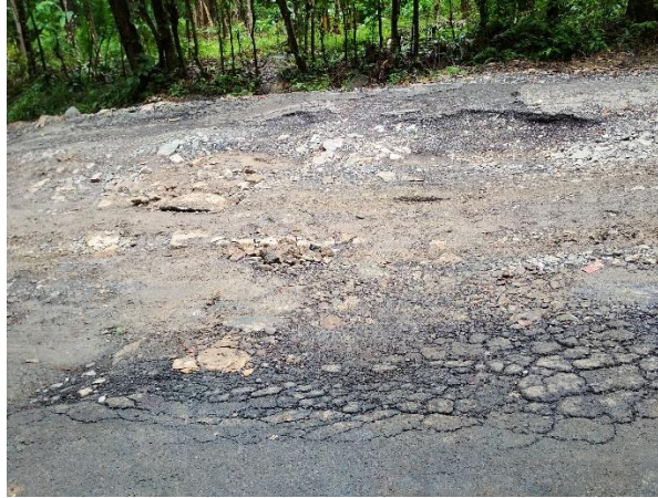
Gambar 1. Kondisi Jalan Taman Nasional Ujung Kulon Sumber: Dokumentasi Penulis, 2018
