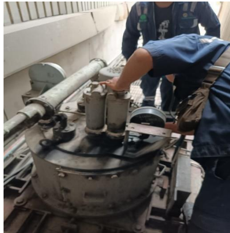
Gambar 5. 7 Pengekan Pompa pada Guide Bearing
