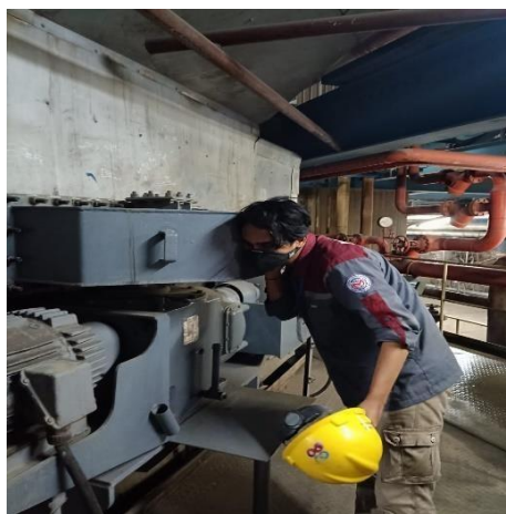
Gambar 5. 3 Periksa Kelainan Suara pada Gear Drive
