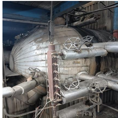
Gambar 3.14 Steam Drum (Sumber : Dokumentasi Pribadi)
