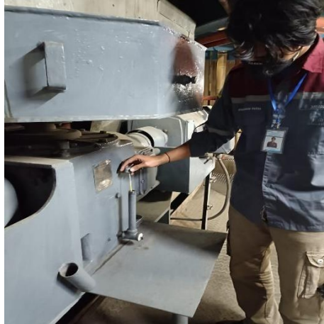
Gambar 5. 2 Pemeriksaan Level Oli pada Gear Drive
