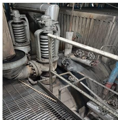
Gambar 3.21 Safety Valve (Sumber : Dokumentasi Pribadi)
