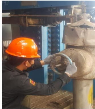
Gambar 4.17 Pemeriksaan Isolating Valve
