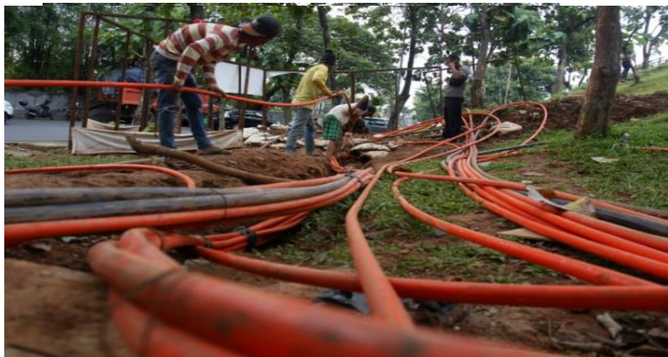
Gambar 3.13 Kabel tanah KT-96 pada link Cikupa-Ciwandan
