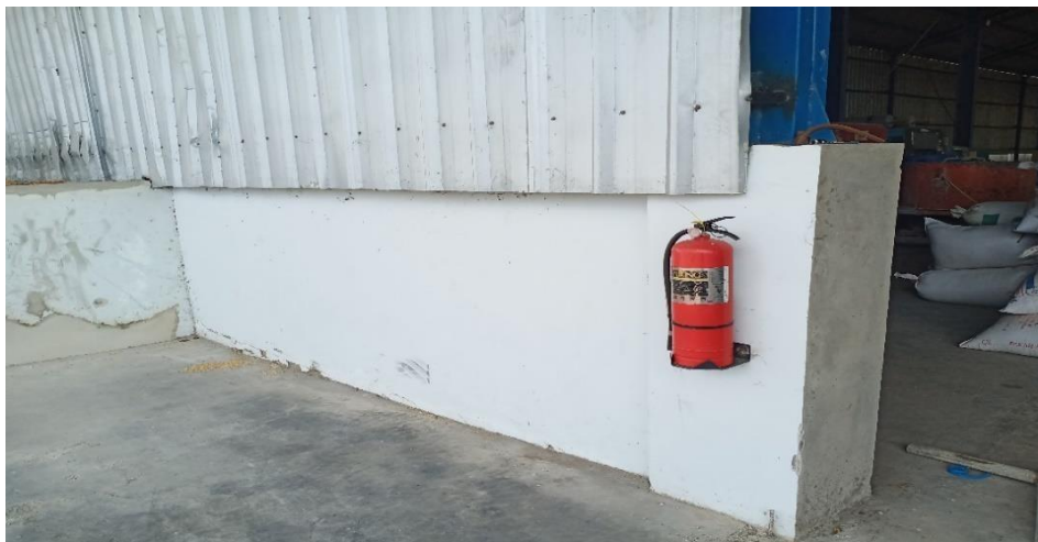
Gambar 4.2 Tabung pemadam kebakaran
