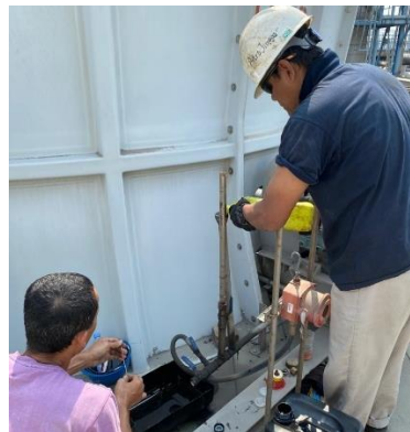
Gambar 4.10 Pergantian Oli pada Pompa Cooling Tower (Sumber : Pribadi)
