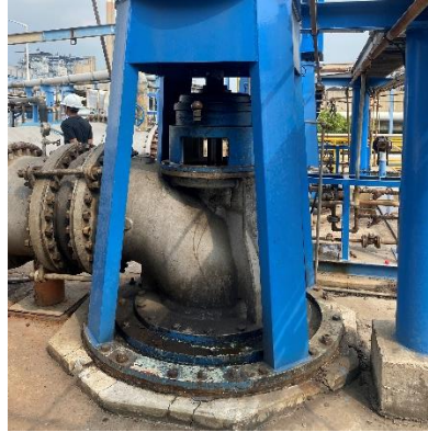
Gambar 4.15 Kunjungan Pompa yang berada di Jetty (Sumber : Pribadi)
