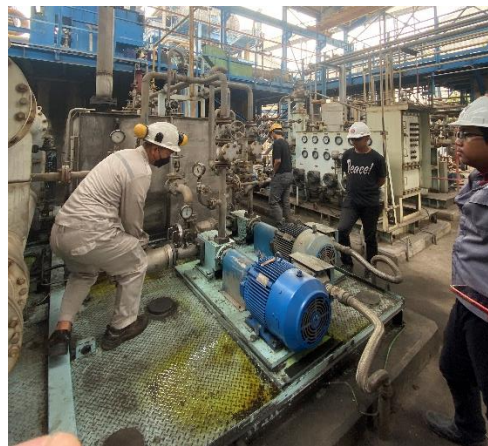
Gambar 4.14 Pengecekan Pressure pada Pompa
