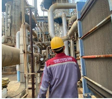
Gambar 4.5 Kunjungan pada Heat Exchanger (Sumber : Pribadi)
