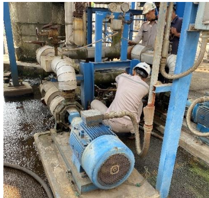
Gambar 4.16 Maintenance pada Pompa (Sumber : Pribadi)
