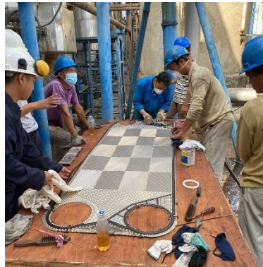
Gambar 4.6 Maintenance pada Plate Heat Exchanger (Sumber : Pribadi)
