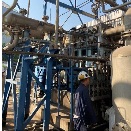
Gambar 4.17 Pengecekan pada Kompresor (C-320)
