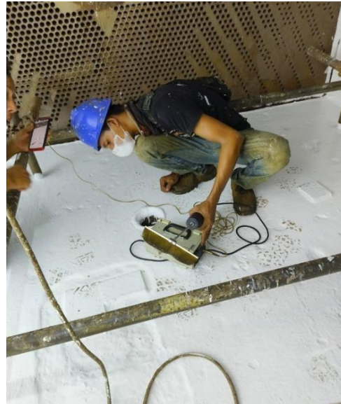
Gambar 5. 6 Megukur ketebalan cat pada permukaan kondensor dengan Holiday Detector
