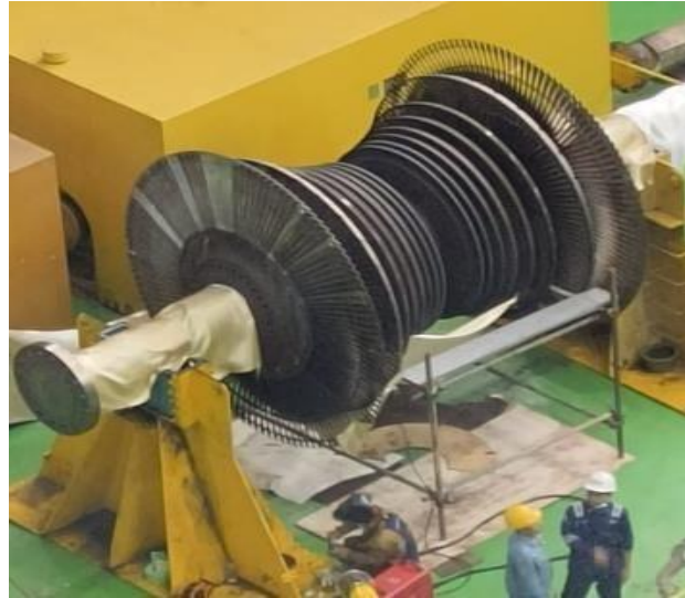
Gambar 5. 8 Perbaikan Rotor Turbin dengan Memotong Bagian yang terkena crack dengan cara memotong sudunya dan dilakukan pengelasan
