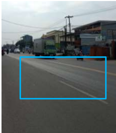
Gambar 5.5 Kerusakan Pada Daerah Pasar Klodran
