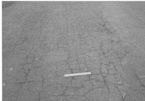
Gambar 3.4 Retak Kulit Buaya ( High Severity )
