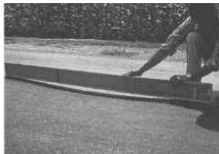
Gambar 3.9 Kerusakan Ambles ( Depression )
