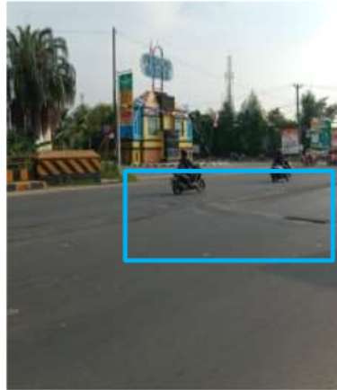
Gambar 5.4 Kerusakan Depan Perumahan Persada Banten
