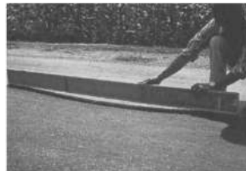
Gambar 3.9 Kerusakan Amblas ( Depression )
