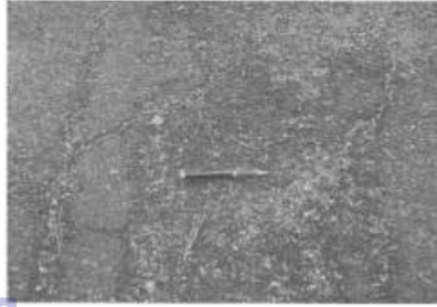
Gambar 3.22 kerusakan Pelepasan Butir ( Weathering and Ravelling )
