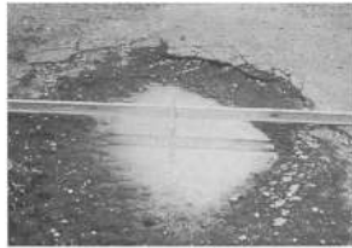
Gambar 3.16 kerusakan lubang ( Potholes )
