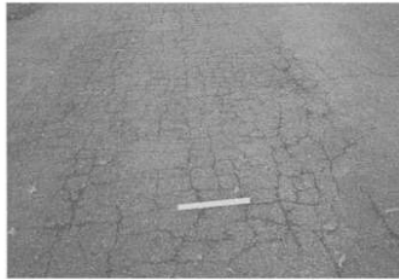
6 Gambar 3.4 Retak Kulit Buaya ( High Severity )
