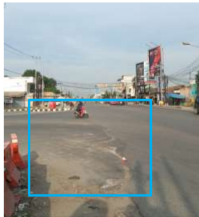
Gambar 5.3 Kerusakan Simpang Jalan Raya Serang Jakarta
