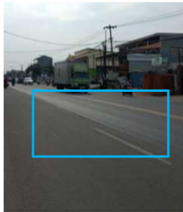
Gambar 5.5 Kerusakan Pada Daerah Pasar Klodran
