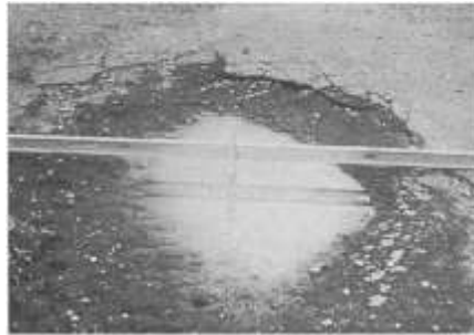
Gambar 3.16 kerusakan lubang ( Potholes )
