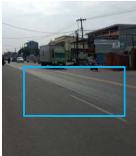
Gambar 5.5 Kerusakan Pada Daerah Pasar Klodran
