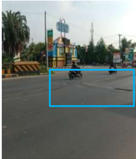
Gambar 5.4 Kerusakan Depan Perumahan Persada Banten
