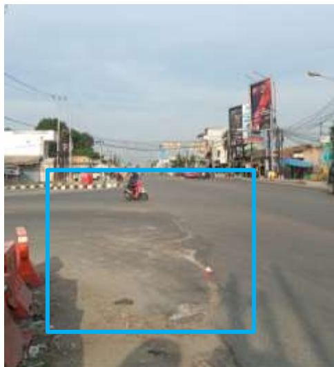
Gambar 5.3 Kerusakan Simpang Jalan Raya Serang Jakarta
