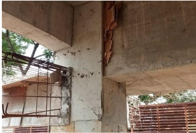
Gambar 4.36 Beton Mengalami Kerusakan
