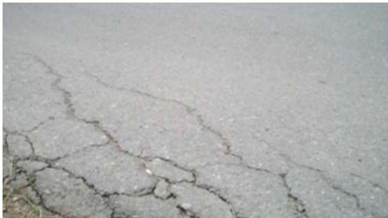
Gambar 3.4 Jenis Kerusakan Retak Pinggir ( Edge Crack )
