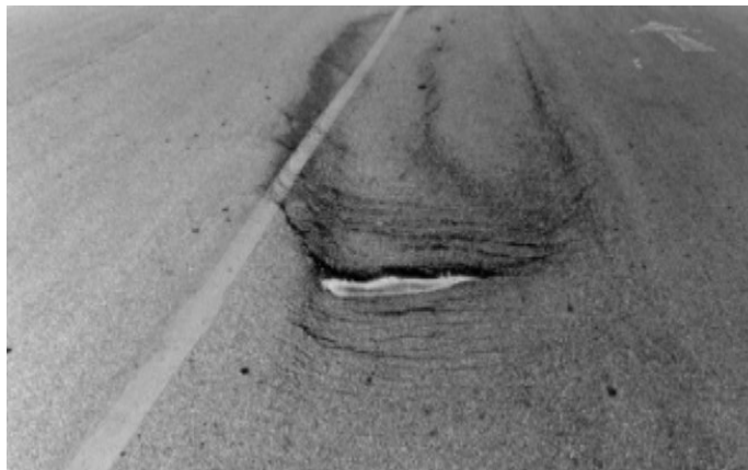
Gambar 3.8 Jenis Kerusakan Retak Selip ( Slippage Crack )
