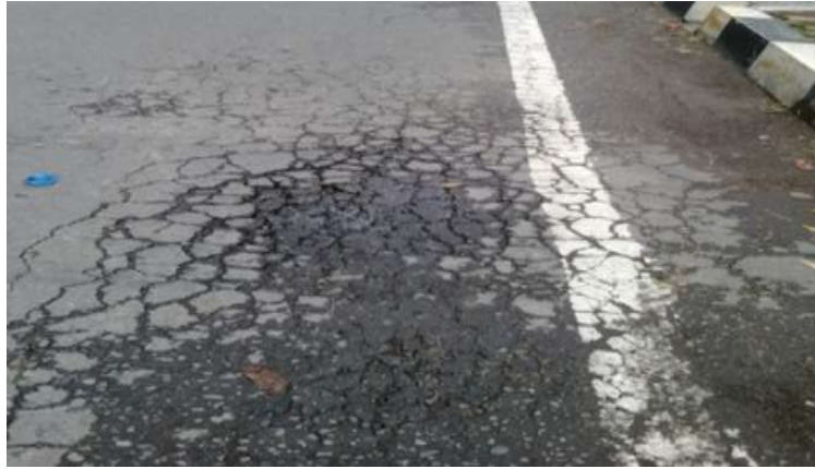
Gambar 3.3 Jenis Kerusakan Retak Kulit Buaya ( Alligator Crack )
