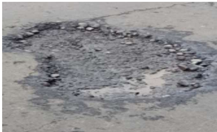
Gambar 3.15 Jenis Kerusakan Pelepasan Butir ( Raveling )
