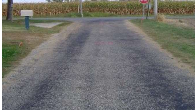
Gambar 3.18 Jenis Kerusakan Kegemukan ( Bleeding or Flushing )
