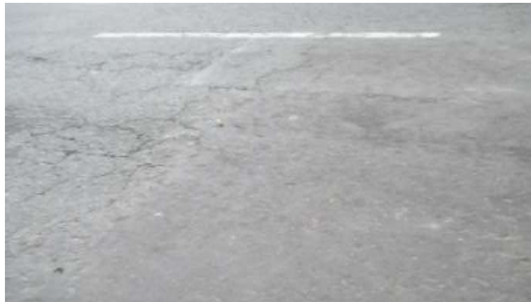
Gambar 3.2 Jenis Kerusakan Retak Halus ( Hair Cracking )
