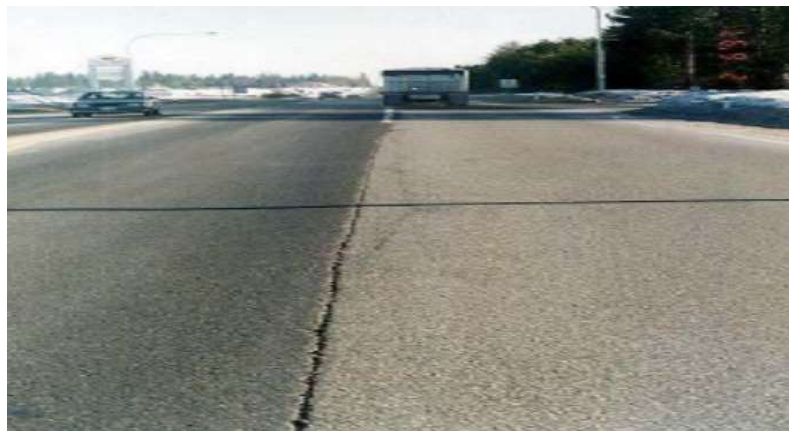
Gambar 3.6 Jenis Kerusakan Retak Sambungan Jalan ( Lane Joint Crack )
