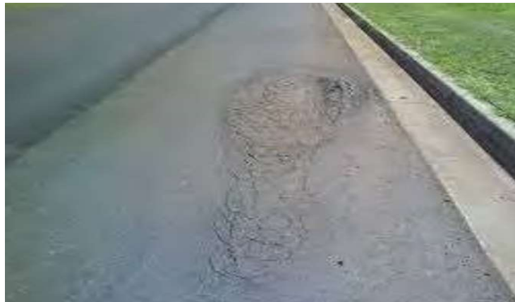
Gambar 3.11 Jenis Kerusakan Sungkur ( Shoving )
