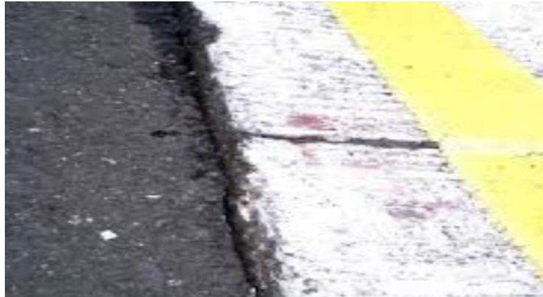
Gambar 3.2 Jenis Kerusakan Retak Sambungan Pelebaran Jalan ( Widening Crack )
