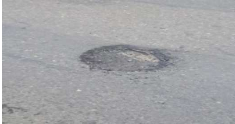
Gambar 3.14 Jenis Kerusakan Lubang ( Potholes )
