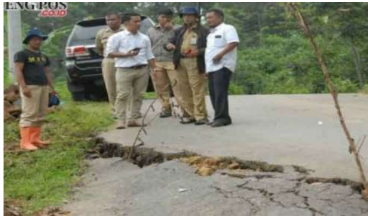
Gambar 3.12 Jenis Kerusakan Amblas ( Grade Depressions )
