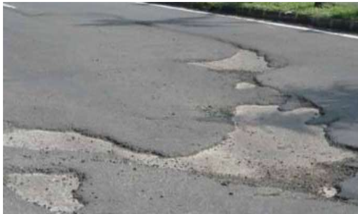
Gambar 3.16 Jenis Kerusakan Pengelupasan Lapisan Permukaan ( Stripping )
