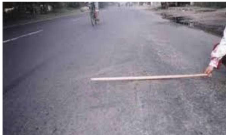
Gambar 3.13 Jenis Kerusakan Jembul ( Upheaval )
