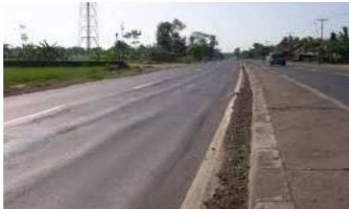
Gambar 3.9 Jenis Kerusakan Alur ( Ruts )
