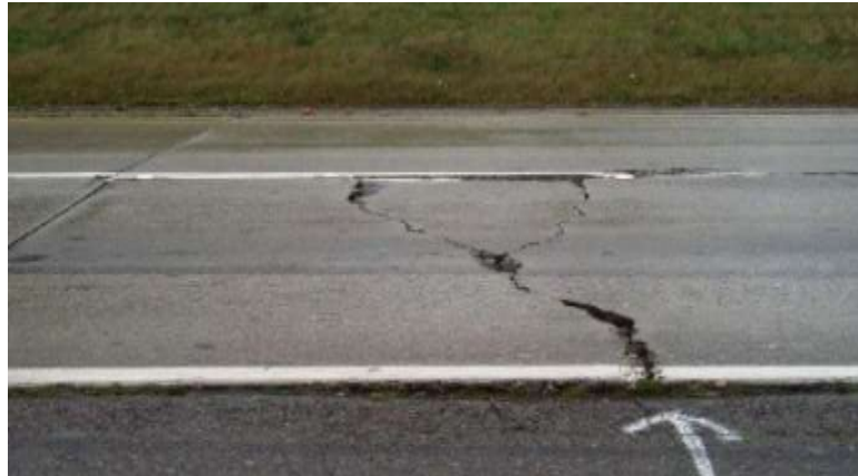
Gambar 3.5 Jenis Kerusakan Retak Sambungan Bahu dan Perkerasan ( Edge Joint Crack )
