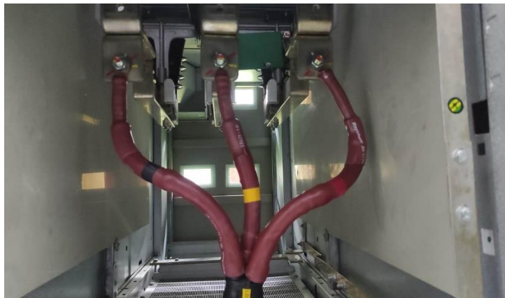
Gambar 4.2 Terminasi Kabel Koneksi Panel Kubikel
