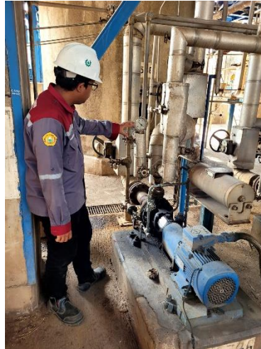
Gambar 5.10 Pemeriksaan Level Pressure
