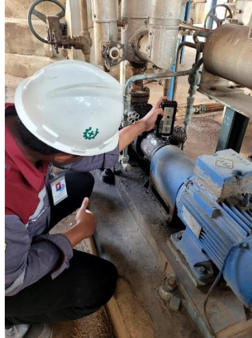
Gambar 5.9 Pemeriksaan Vibrasi Pompa
