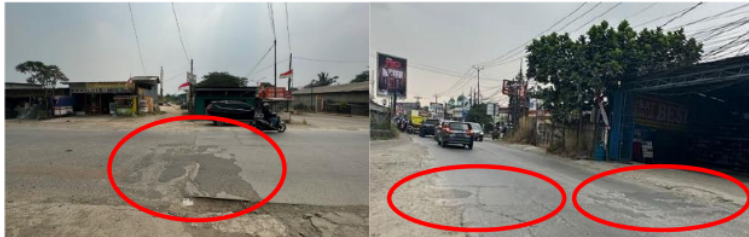
Gambar 1.1 Kondisi Jl. Karawaci – Legok Sebelum Proyek Rehabilitasi dan Peningkatan Jalan
