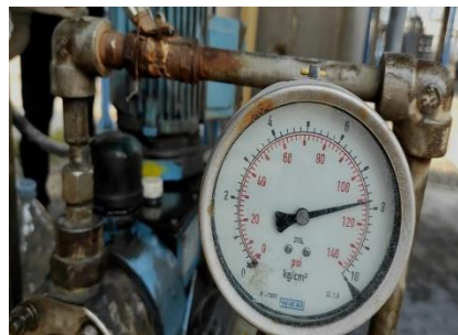
Gambar 4.17 Pressure Gauge pada saluran Discharge
