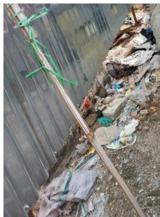
Gambar 4.48 Sampah Berserakan Di Area Proyek
