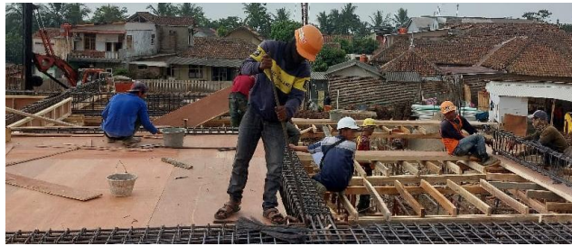
Gambar 4.47 Para Tukang Yang Tidak Menggunakan APD Secara Lengkap
