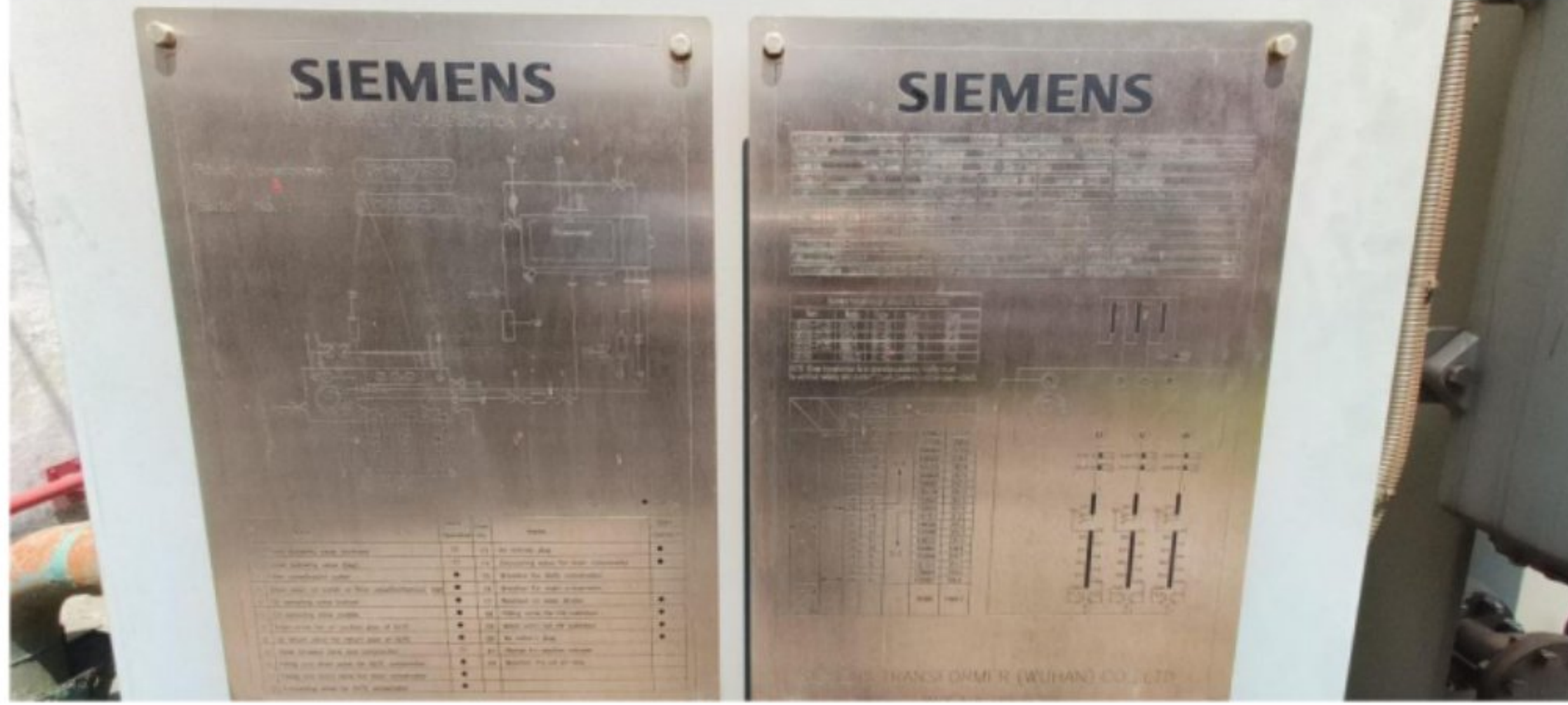
Gambar B-5 Name Plate Transformator AV 08
