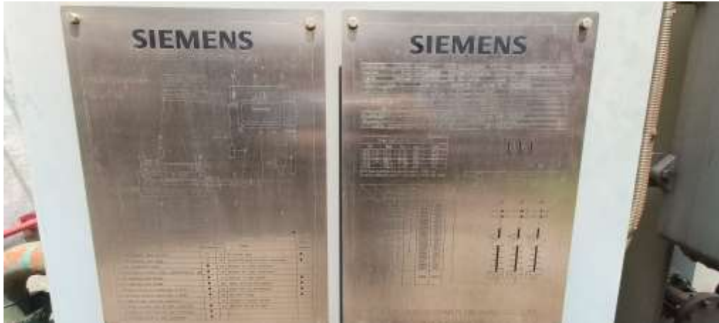
Gambar B-5 Name Plate Transformator AV 08
