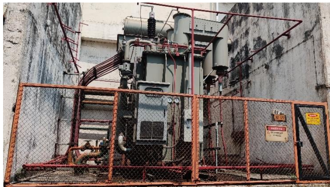
Gambar 4. 1 Wujud Transformator AV 08 MTS 2
