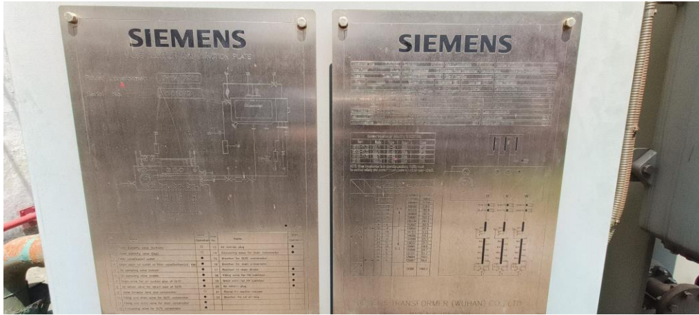
Gambar B-5 Name Plate Transformator AV 08
