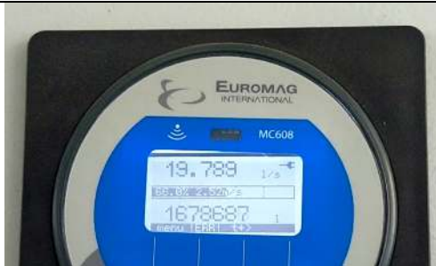
Gambar L-4.3. 14 Pembacaan Q_a = 19,789 l/s Putaran Pompa 6 –Kondisi Pintu Tertutup
