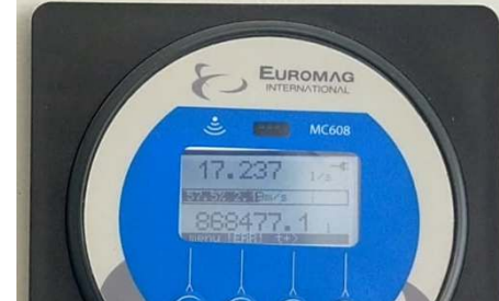
Gambar L-4.3. 12 Pembacaan Q_a = 17,237 l/s Putaran Pompa 5,5 –Kondisi Pintu Tertutup
