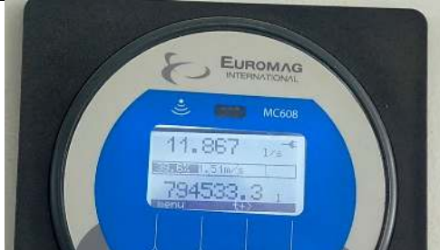
Gambar L-4.3. 7 Pembacaan Q_a = 11,867 l/s Putaran Pompa 4,45 –Kondisi Pintu Tertutup
