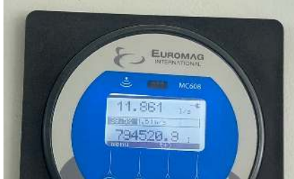
Gambar L-4.3. 5 Pembacaan Q_a = 11,861 l/s Putaran Pompa 4,5 –Kondisi Pintu Tertutup
