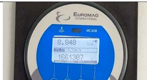
Gambar L-4.3. 2 Pembacaan Q_a = 8,848 l/s Putaran Pompa 4,0 –Kondisi Pintu Tertutup
