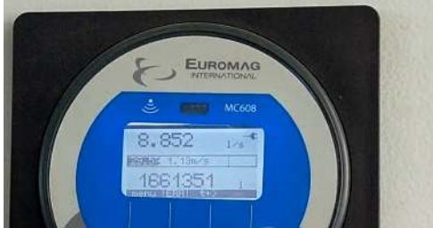
Gambar L-4.3. 4 Pembacaan Q_a = 8,852 l/s Putaran Pompa 4,0 –Kondisi Pintu Tertutup
