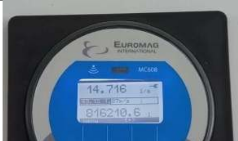
Gambar L-4.3. 8 Pembacaan Q_a = 14,716 l/s Putaran Pompa 5,0 –Kondisi Pintu Tertutup
