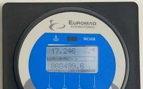
Gambar L-4.3. 10 Pembacaan Q_a = 17,246 l/s Putaran Pompa 5,5 –Kondisi Pintu Tertutup
