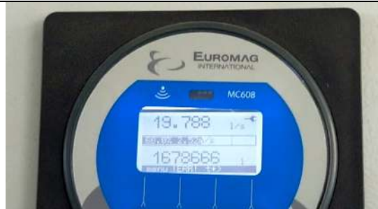
Gambar L-4.3. 13 Pembacaan Q_a = 19,788 l/s Putaran Pompa 6 –Kondisi Pintu Tertutup
