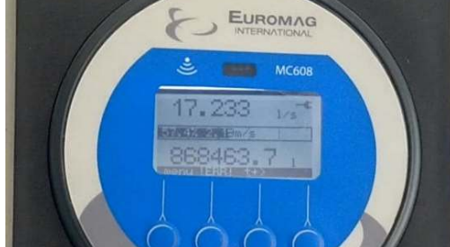
Gambar L-4.3. 11 Pembacaan Q_a = 17,233 l/s Putaran Pompa 5,5 –Kondisi Pintu Tertutup
