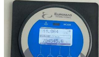
Gambar L-4.3. 6 Pembacaan Q_a = 11,864 l/s Putaran Pompa 4,5 –Kondisi Pintu Tertutup
