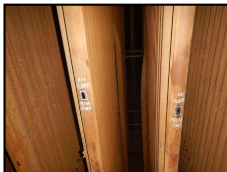
Gambar 2. Material tube SA 213 pada Boiler
