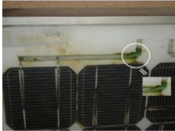
Gambar 2.3 Korosi pada Panel Surya [24]
