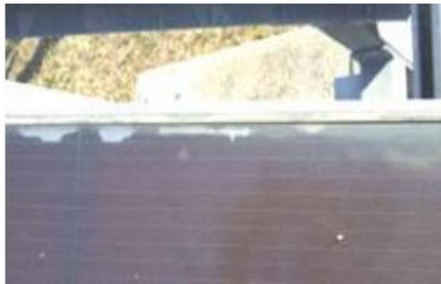
Gambar 2.2 Delamination pada Panel Surya [20]
