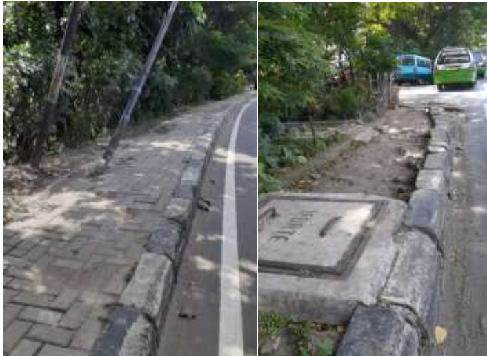
Gambar 5.48 Kondisi Trotoar Jalan pada Segmen 4
