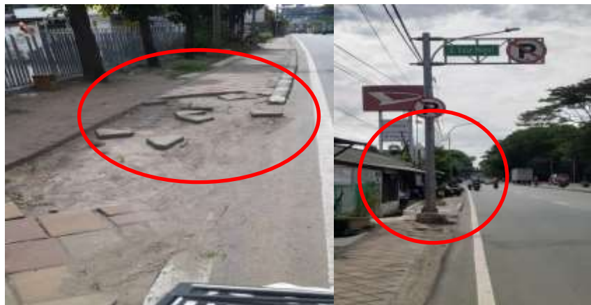
Gambar 5.41 Trotoar Jalan Yang Tidak Layak
