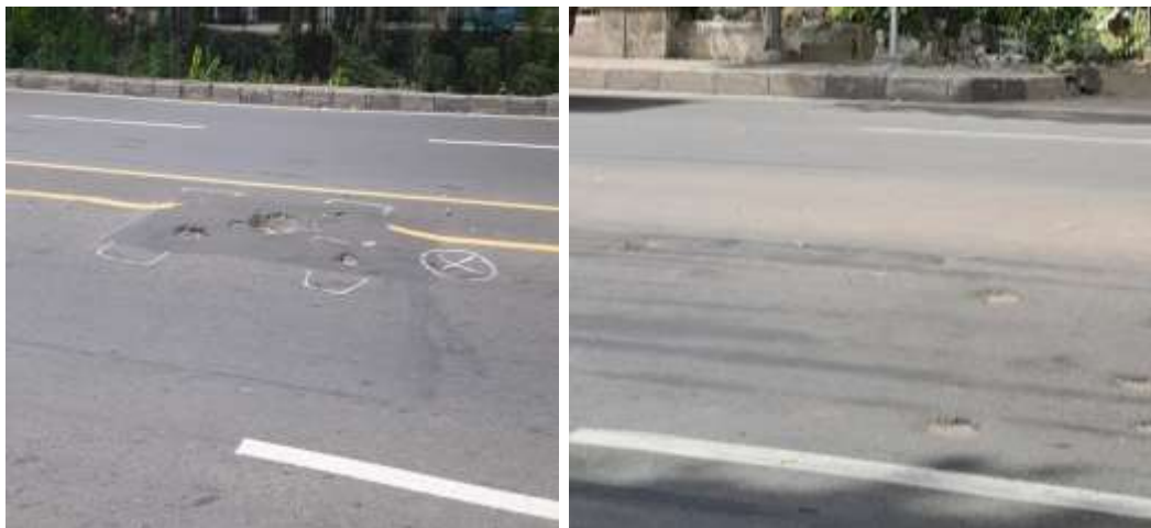
Gambar 5.42 Kondisi Jalan Berlubang
