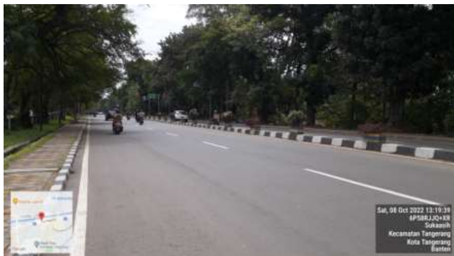
Gambar 5.5 Keadaan Jalan Segmen 2 Sukaasih, Tangerang
