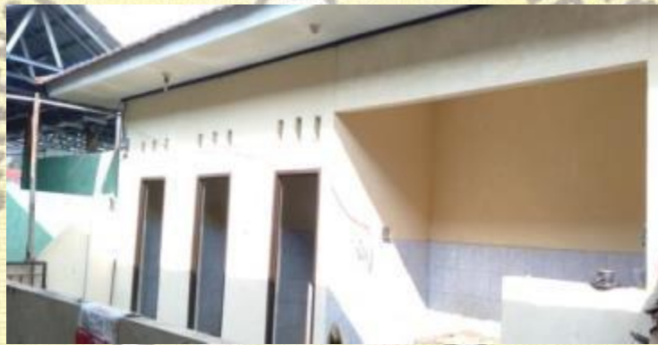
Toilet belakang Pasar Petir Kabupaten Serang
