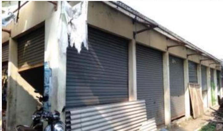
Kondisi kios belakang yang tidak digunakan di Pasar Petir Kabupaten Serang
