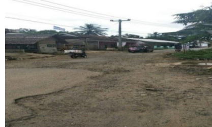
Gambar 1. Kerusakan Jalan di Lokasi Studi Kasus
