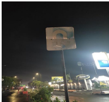
Rambu Petunjuk (Warna pudar dan Daun Rambu Penyok) Tidak Sesuai dengan PERMENHUB No.13 Tahun 2014
