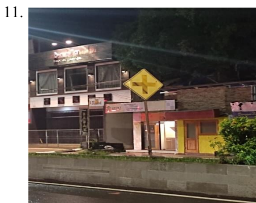
Rambu Peringatan (Warna Pudar) Tidak Sesuai dengan PERMENHUB No.13 Tahun 2014
