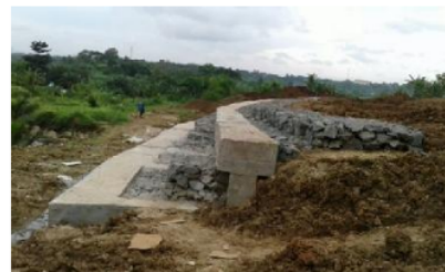
Gambar 2. Kondisi di Lapangan (Sumber: Dokumentasi Penulis, 2017)
