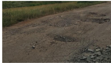
Gambar 1. Kerusakan jalan di Jalan Desa Masjid Priyayi, Kec. Kasemen, Kota Serang
