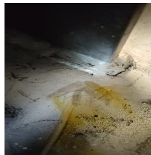
Gambar 4.4 Cacat Retak (Sumber: Dokumen Pribadi)
