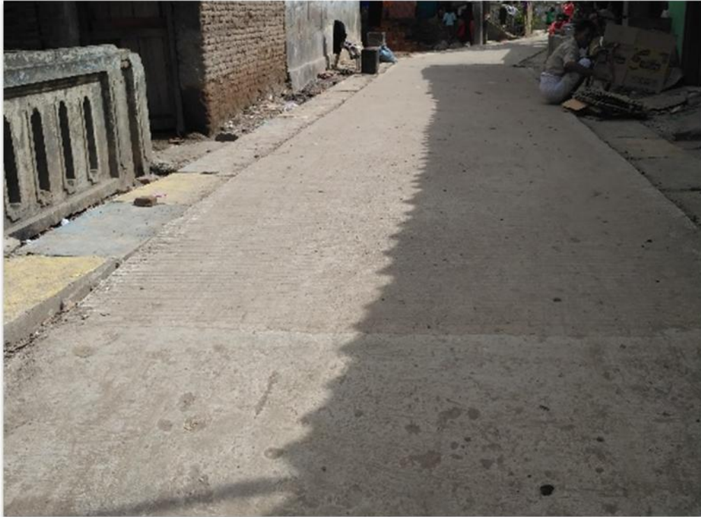
Kondisi jalan lingkungan di Kelurahan Warung Jaud
